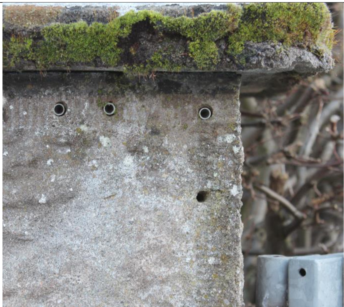
Die Spalte zwischen Deckplatte und Mauerwerk, die drei Dübel, das leere Bohrloch und das Loch im Türrahmen.
